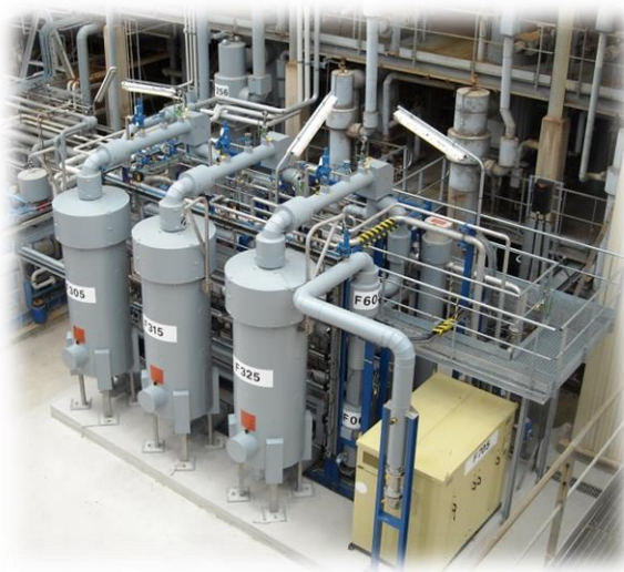
VF 2 Dryer 1800 Nm 3 /h – 2.4 barg
